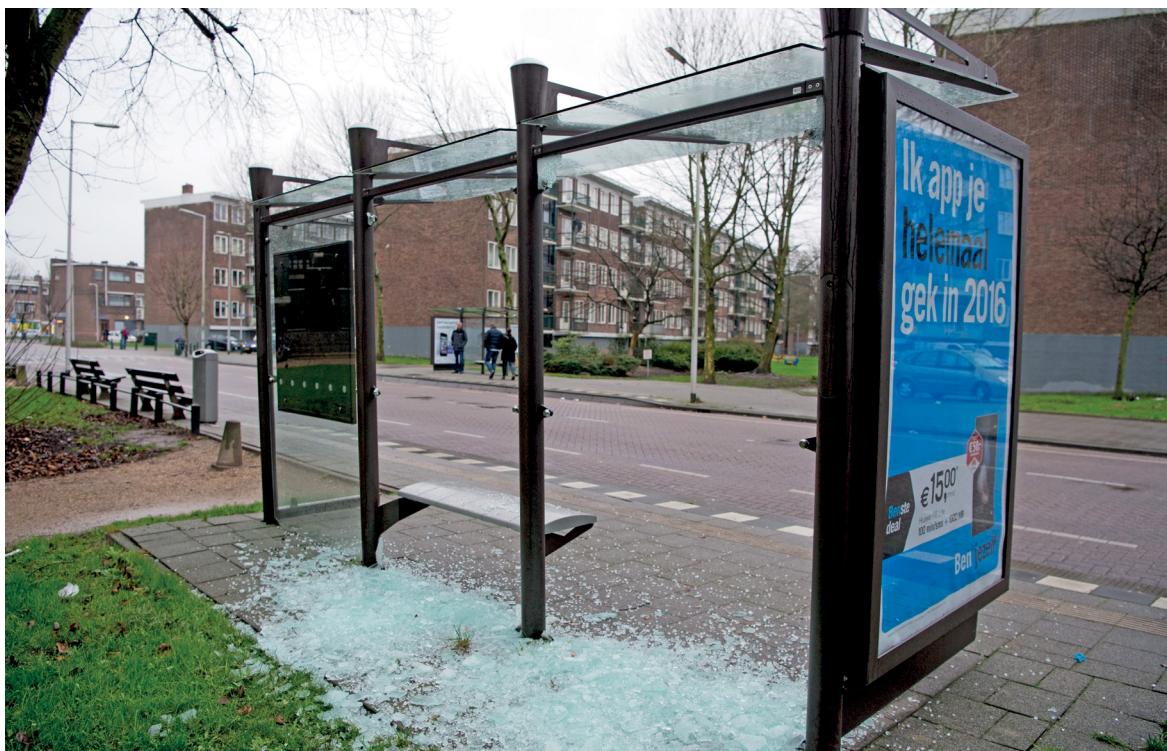
Figuur 10: Schade door illegaal vuurwerk. (Foto: Robin van Utrecht/Hollandse Hoogte)
